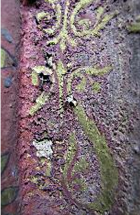
23. Aufstehende Malschicht im Gewandbereich der Chorpfeilerfigur des Apostels Bartholomäus, Vorrestaurierungszustand.
