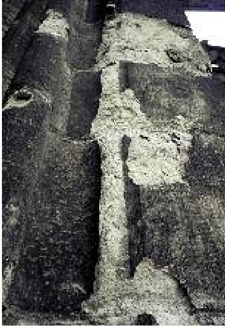
3. Beschädigtes Steinwerk an der Laibung des Chorobergadenfensters S IV.
