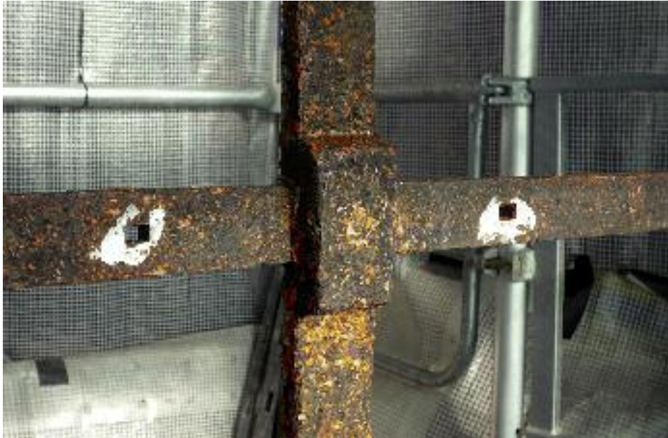
14. Mittelalterliches Windeisen des Fensters S III mit fehlenden Nocken.
